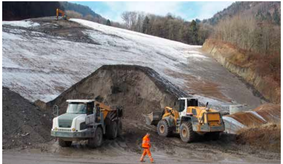
Die stillgelegte Tongrube Fasiswald – eigentlich «Höchweidli», so der vergessene Flurname – ist mit etwa 470'000 Kubikmetern Aushub, sogenanntem Gipskeuper, der dritten Tunnelröhre der A2 am Belchen praktisch aufgefüllt. Rechts im Bild ist die Nagelwand zu sehen, die gemäss Kanton erhalten werden musste.
